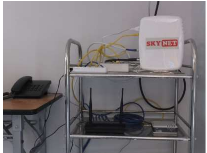
設置された電話機、ルーター
