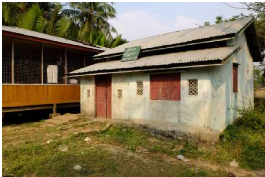
図書館外観（右）（補修前）
