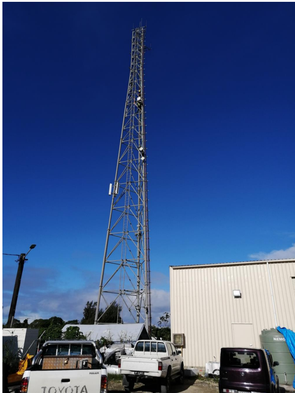
コンポーネント1及び2用の無線局用鉄塔（高さ40m）
