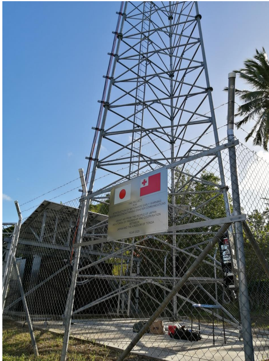
コンポーネント3 FM再送信局用の鉄塔（ニウアス諸島に3箇所）
